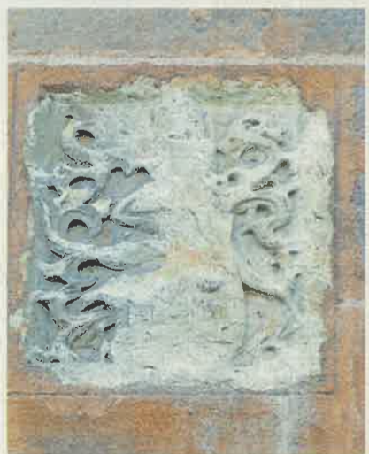
Kritikpunkt Rosenberger Wappen: Auf eine Sanierung wurde verzichtet.
