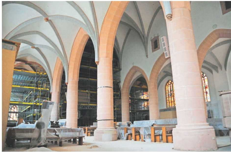
Groß-Baustelle noch für ein weiteres Jahr. Ein Teil des Gerüsts ist schon abgebaut und gibt wieder den Blick frei auf das beeindruckende Innere der Stadtkirche. Eingerüstet ist aber noch der westliche Teil des Kirchenschiffs. Foto: Gerner
