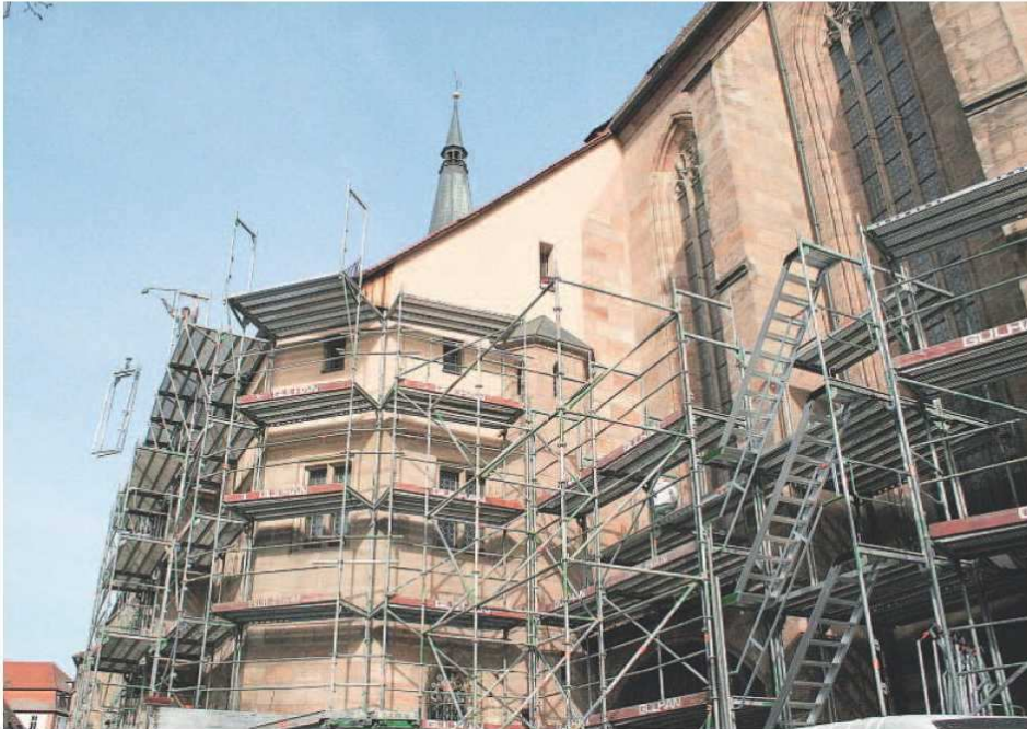
Der zweite Bauabschnitt der Sanierung der Schwabacher Stadtkirche hat mit dem Aufstellen des Gerüsts begonnen. Die Arbeiten am Turm werden im Mai beendet. Foto: Hess
