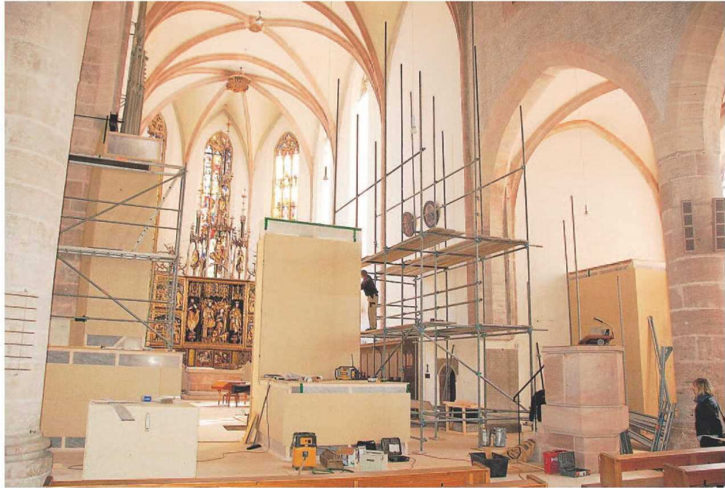
Baustelle Stadtkirche: Die Altäre verschwinden hinter Holzkästen. So werden sie während der dreijährigen Bauzeit gesichert.
