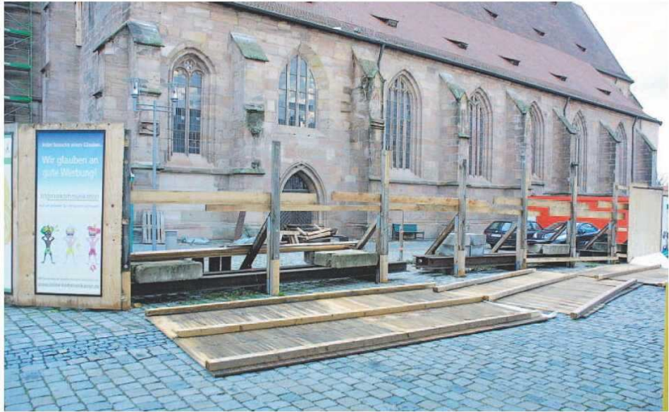
Der Bauzaun um die Stadtkirche hielt dem nächtlichen Sturm nicht stand. Verletzt wurde niemand.
