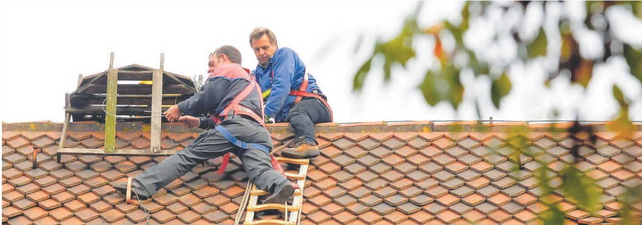
Manfred Pausch und Wolfgang Mühlbacher bei der Arbeit in luftiger Höhe 30 Meter über dem Boden. Sie befestigten das Storchennest in der Mitte des Kirchenschiffes.
