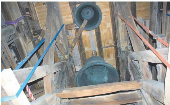
Die Glocken hängen an Stahlseilen auf eigens eingezogenen Hilfsbalken wie Wäsche auf der Leine. Der Glockenstuhl weist massive Schäden auf. Auch er hängt an provisorisch eingezogenen Balken. Spangurte sichern die gesamte Konstruktion. Wasser hat die Lagerbalken zerstört.
