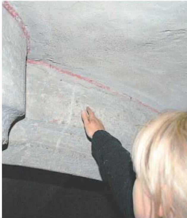
Susanne Meyer deutet auf einen Riss. Hier hat die Rippe keine Verbindung zum Gewölbe. Foto: Hess
